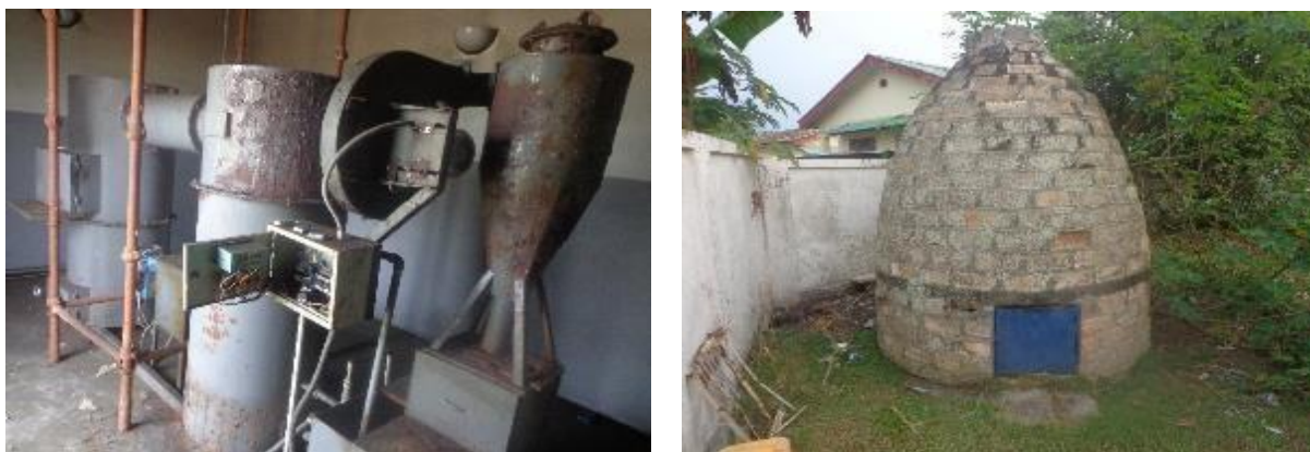
Figure 4: Vues de l'incinérateur de l'hôpital Lucie BONGO ODIMBA (HLBO) en panne et de l'incinérateur du CSI d'Edou fonctionnel mais émettant beaucoup de fumée
